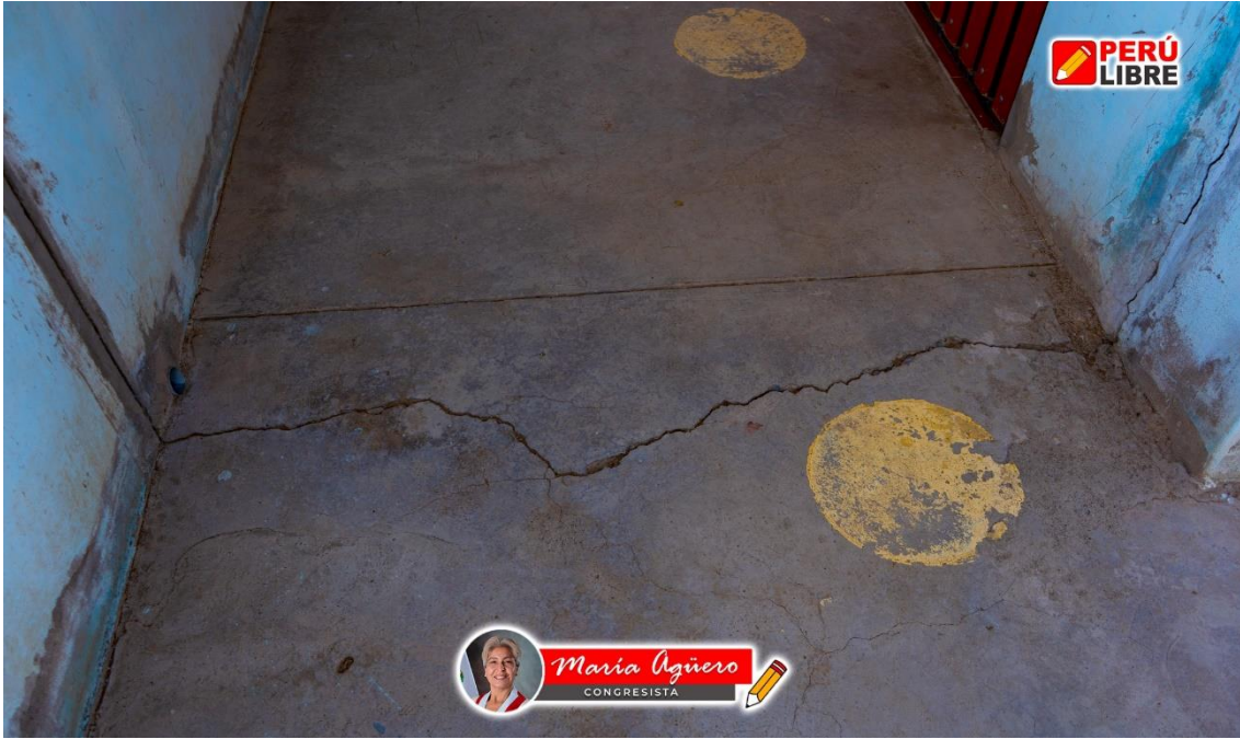
Figura 4. Detalle de la rajadura en el suelo
