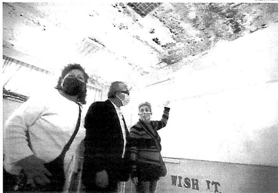
EN MAL ESTADO. Techos de aulas de colegio Independencia presentan filtraciones a causa de las lluvias
