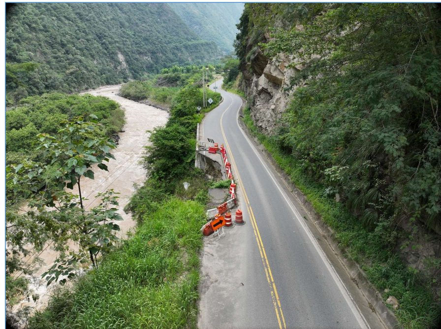
Imágenes aéreas del sector afectado, ubicado en el km 268
