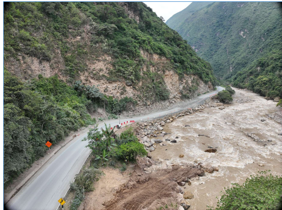
Imágenes aéreas del sector afectado, ubicado en el km 286+550 al km 286+750
