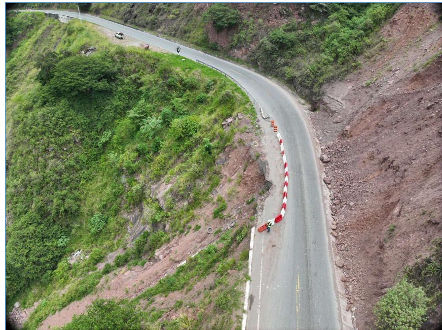
Imágenes aéreas del sector afectado, ubicado en el km 280
