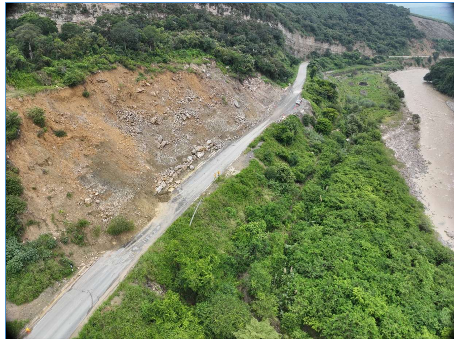
Imágenes aéreas del sector recientemente afectado, ubicado entre el km 255+100 al km 255+350
