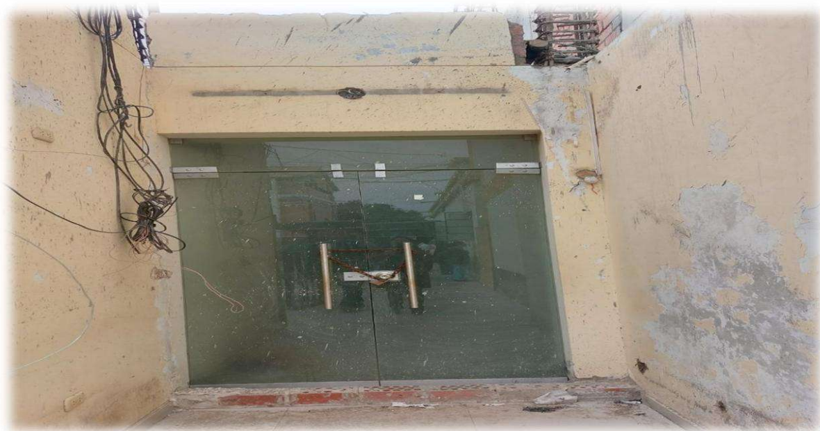
TORRE ONCOLÓGICA ESTADO DE ABANDONO
