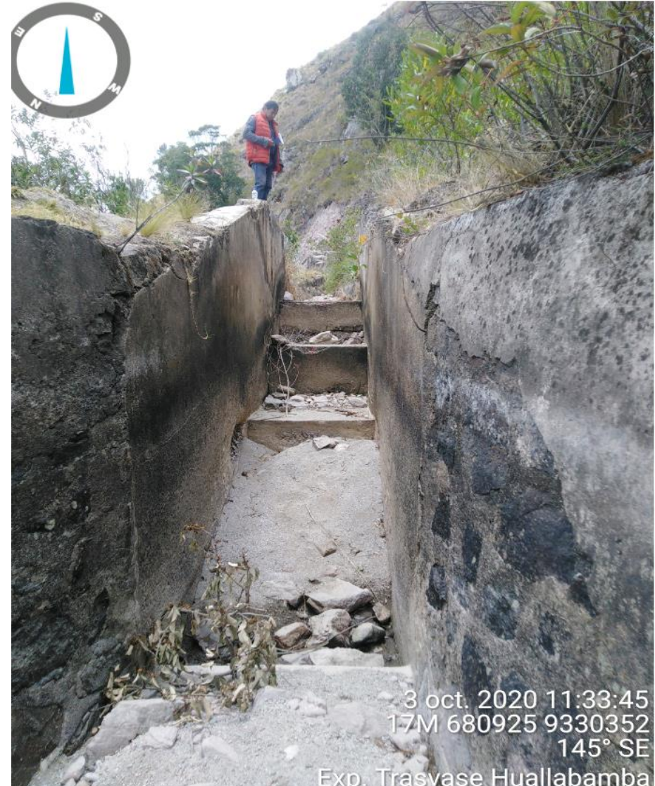
CANAL HUALLABAMBA, KM 8+500, SIN AGUA
