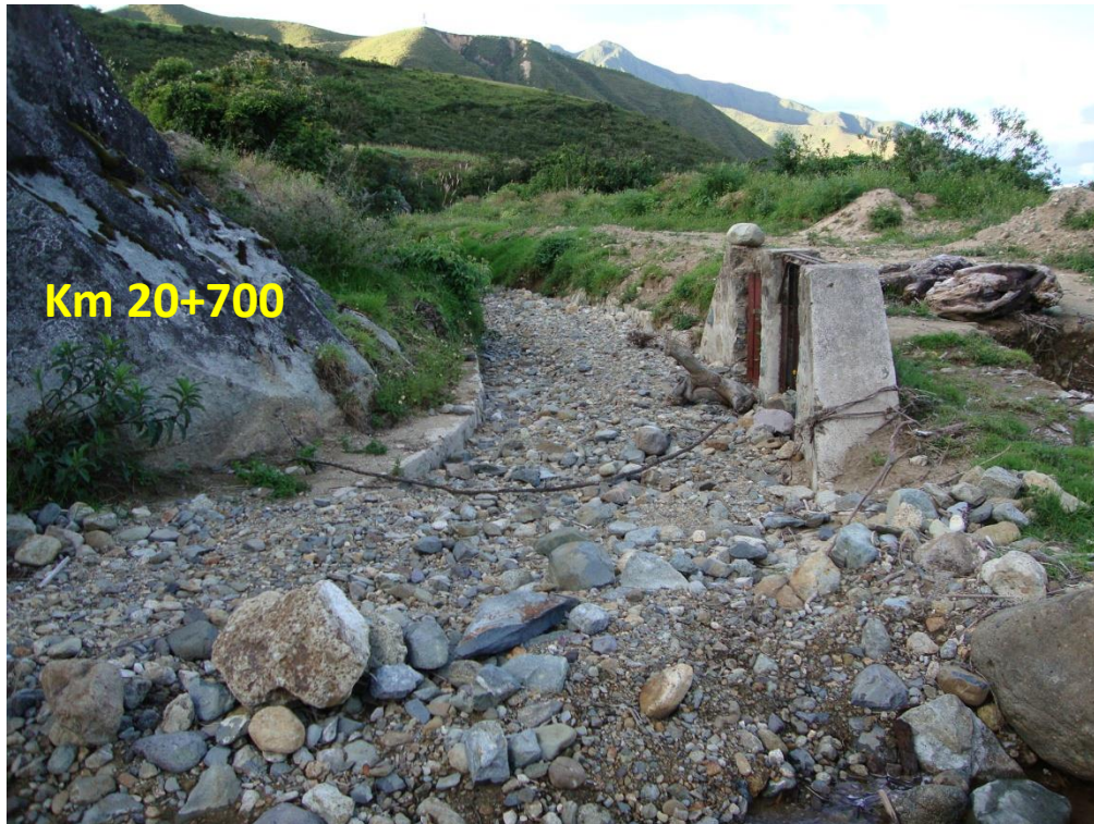
Canal colmatado con canto rodado (Qda. Jarro quebrado). Abril 2010
